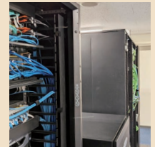
病院情報システムサーバー
